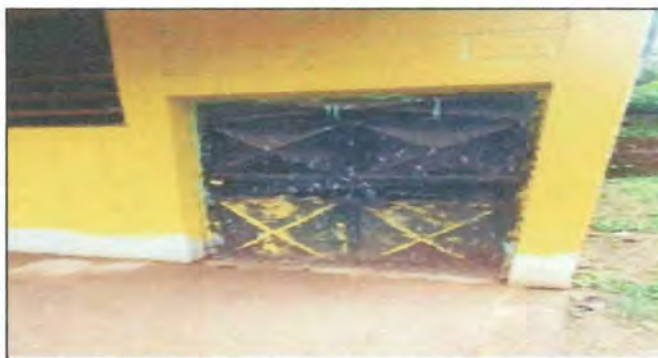
Foto 3: En esta fotografía se observa la necesidad de cambiar esta puerta de metal por una nueva por su mal estado.
