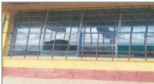
Foto 4: En esta fotografía se observa las ventanas en malas condiciones, del módulo 2.
