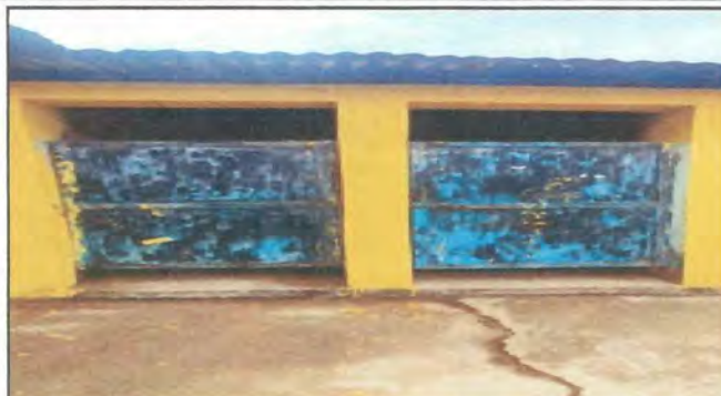
Foto 2: En esta fotografía se observa las puertas de los baños que se encuentran en mal estado es necesario remozarla.
